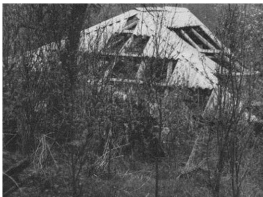
Porušena kuća Himze Stovraga u selu Vukšićima (Snimljeno 30. aprila 2002. godine)
